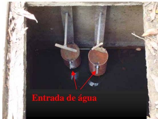
Figura 3. Vista superior do poço de visita com duas garrafas coletoras instaladas, observando-se os parafusos confeccionados para fixar a haste a parede.
