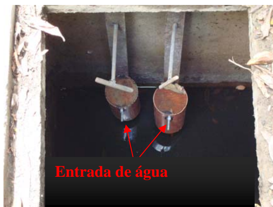
Figura 3. Vista superior do poço de visita com duas garrafas coletoras instaladas, observando-se os parafusos confeccionados para fixar a haste a parede.
